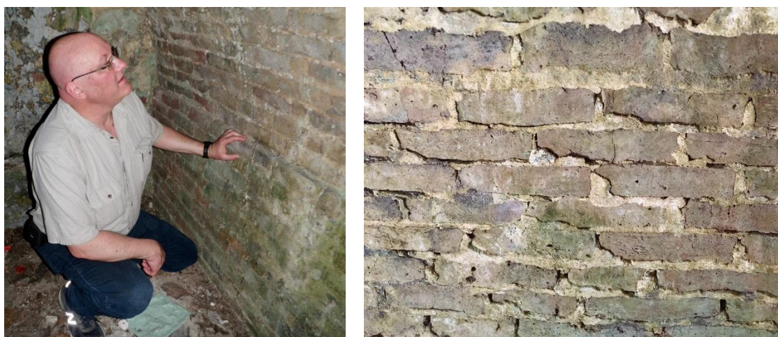
Figure 5. Parois intérieure en briques d'origine du caveau des Chase inspectée par l'auteur, ne présentant pas de signe distinguable de choc causé par les cercueils. Photos prises par Shana Pedroncelli et par l'auteur.
